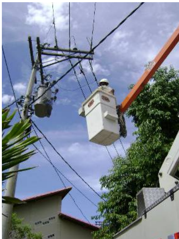
Figura 10: Leitura da placa de identificação de um transformador utilizando um veículo com cesta isolada.
