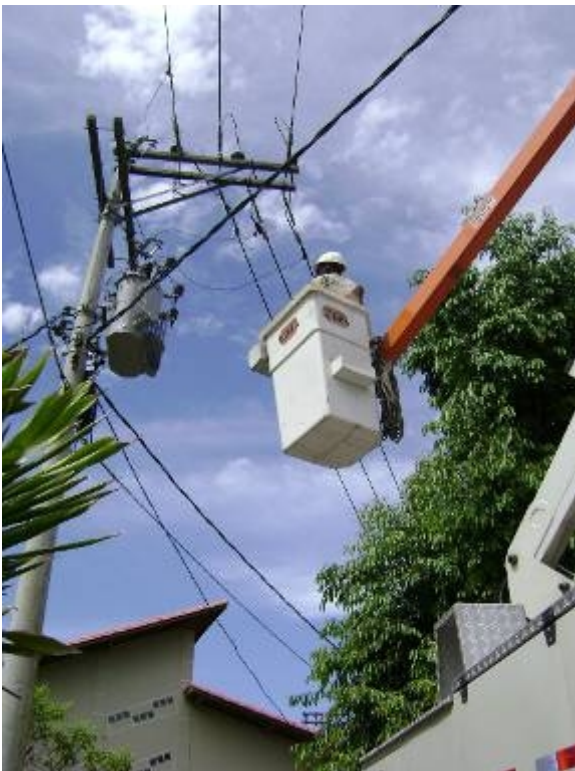
Figura 12. Leitura da placa de identificação de um transformador utilizando um veículo com cesta isolada.
