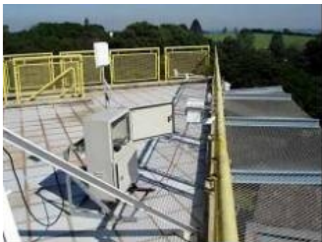
Figura 3. Vista do armário (na Torre 1)
