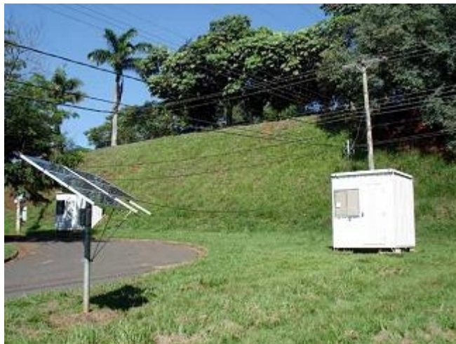
Figura 6. Vista do Shelter 3 e Painel Solar
