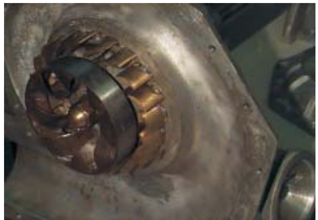
FIGURA 10 - Vista do sistema distribuidor e da unidade pré montada no CPH-UFMG
