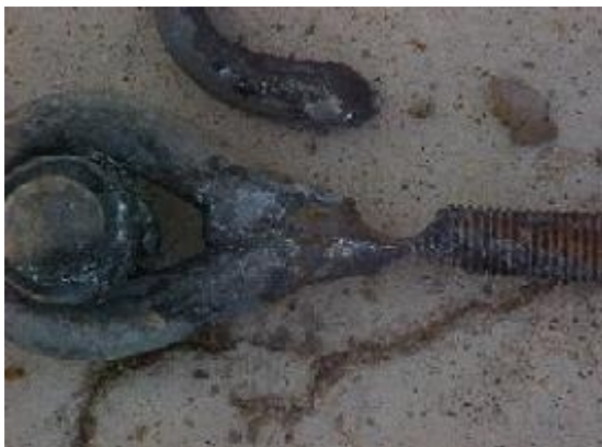
Figura 8.Registro de danos causados por curto circuito em cadeia de isolador.
