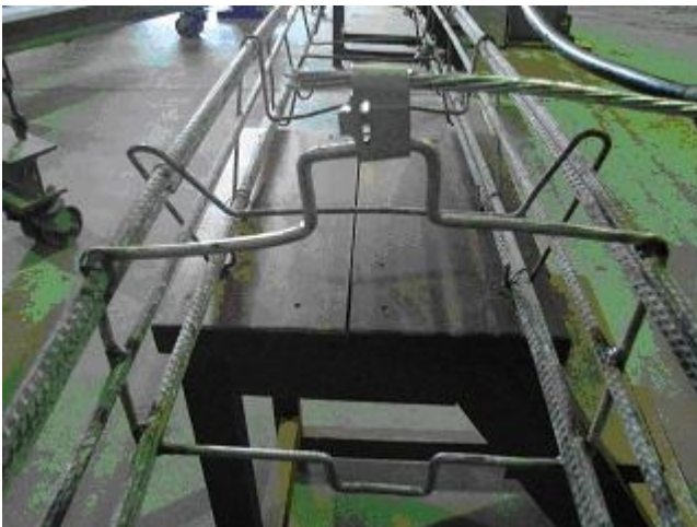
Figura 15. Vista da parte inferior da armação metálica, mostrando a conexão entre o "estribo especial" e os vergalhões.
