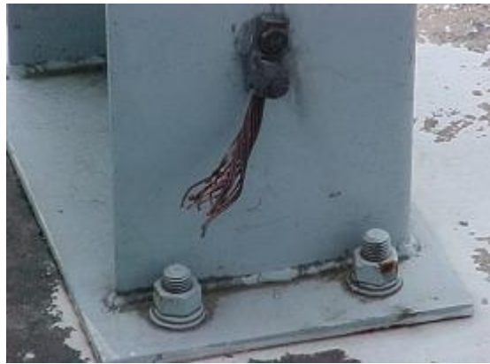
Figura 3. Furto de Cabos de Aterramento na Subestação de Goiana
