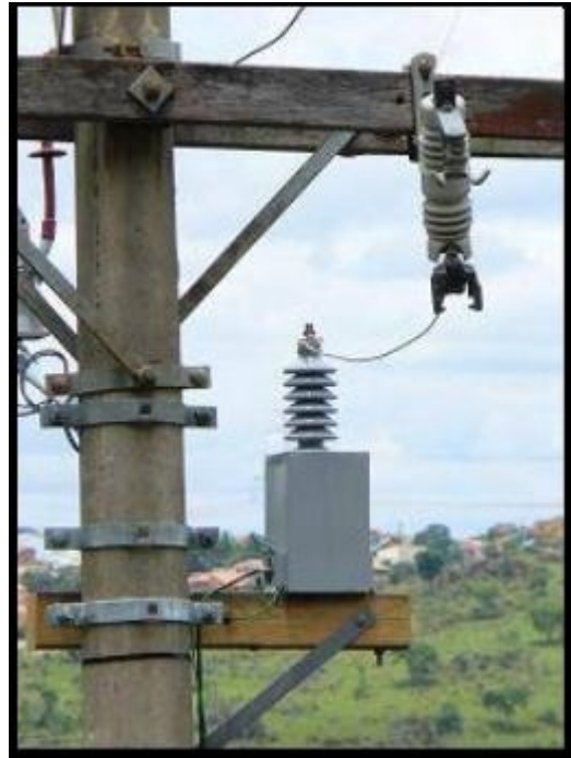
Figura 11. Acoplador PLC instalado junto à rede de média tensão
