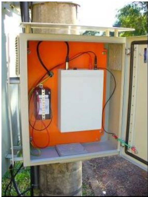
Figura 10. Repetidor PLC instalado no Poste T23
