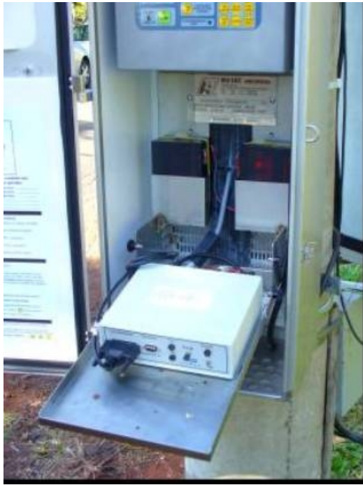
Figura 12. Modem PLC instalado no interior da Unidade Controladora do Religador
