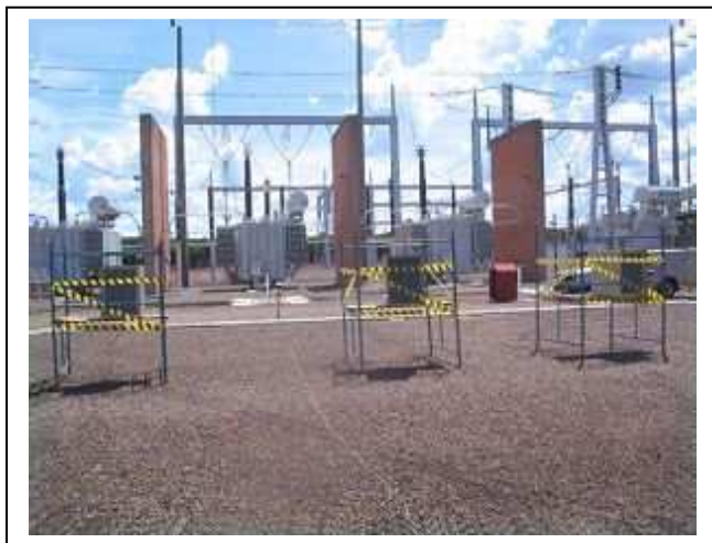
FIGURA 10. Vista das caixas acústicas na subestação de Santa Bárbara d'Oeste.
