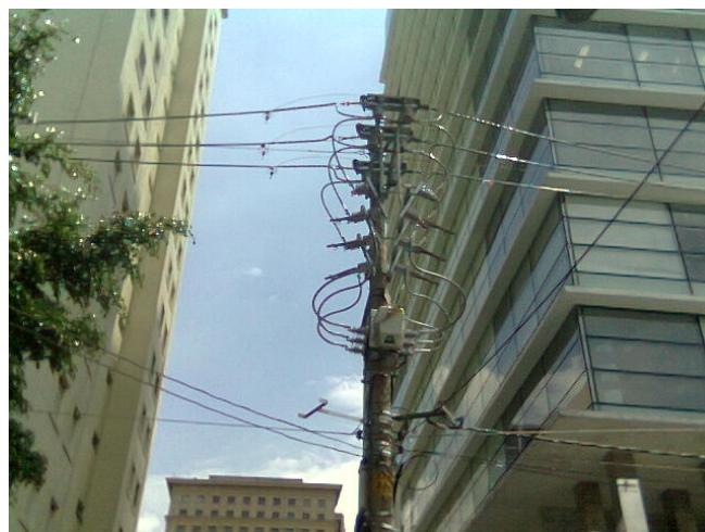
Figura 10. Vista lateral de uma chave instalada.
