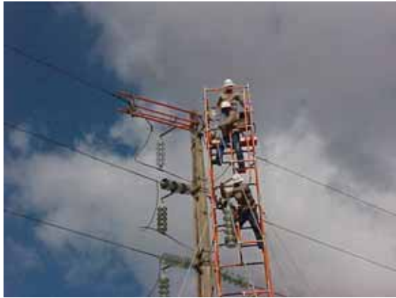
Figura 13 – Retirada da cadeia de isoladores danifica
