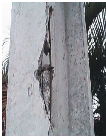
Figura 6 – Poste de Má Qualidade
