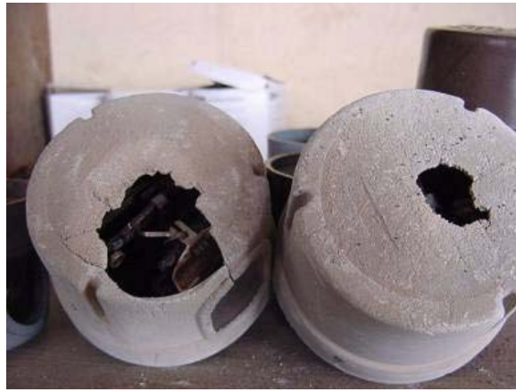
Figura 1 - Degradação do invólucro do relé devido à ação dos raios ultravioleta
