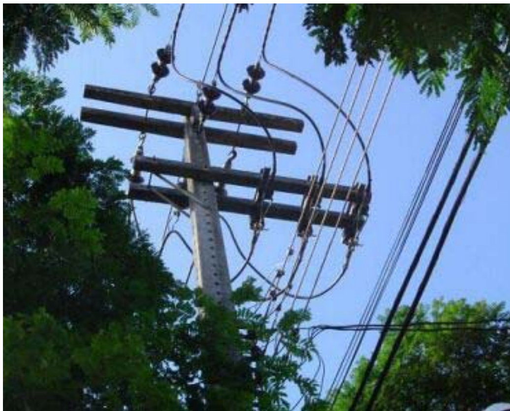
Figura V – Galhos de árvores próximos a equipamentos especiais.
