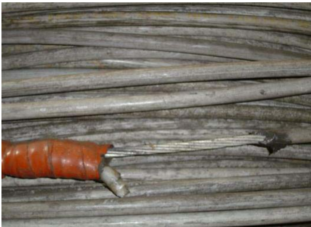
Figura X- Cabos XLPE degradados.
