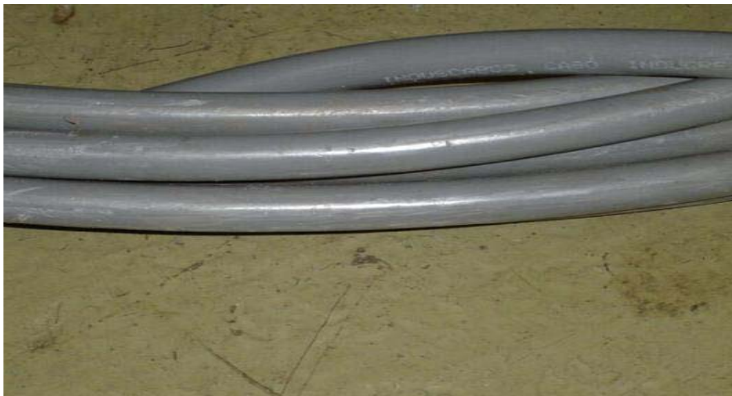
Figura III – Cabos danificados no manuseio
