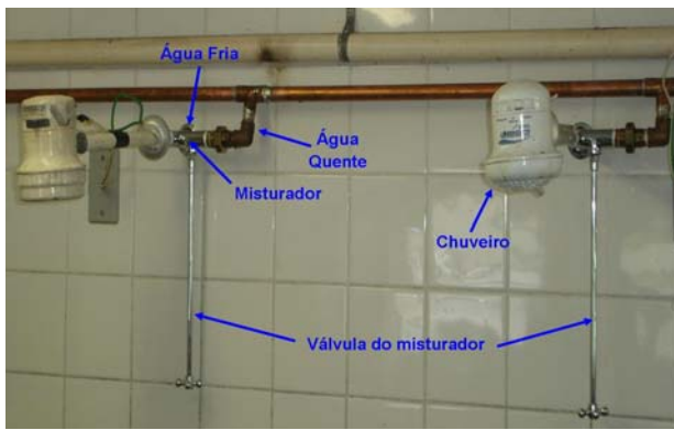
Figura 6 : Detalhes da instalação dos chuveiros.
