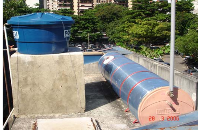
Figura 4 : Reservatório térmico e caixa de água fria
