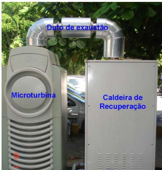
Figura 3 : Microturbina (30 kW) e caldeira de recuperação
